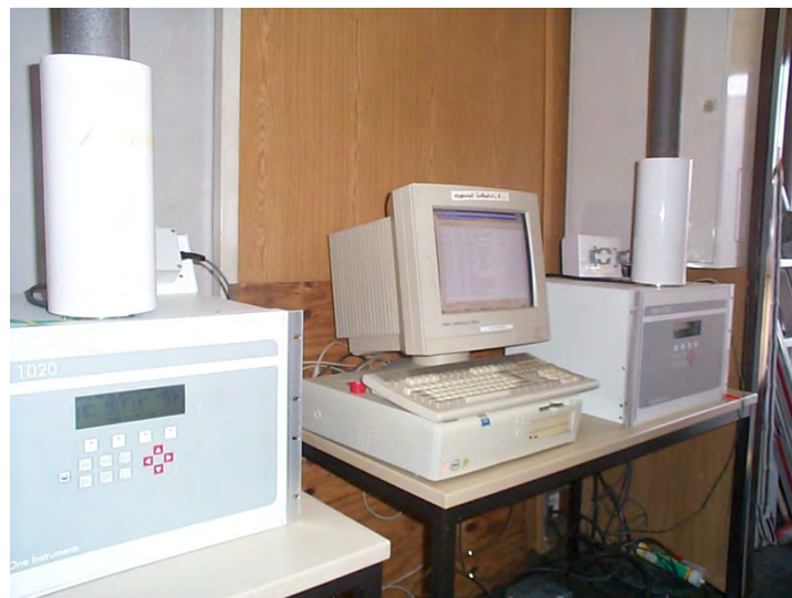
Abbildung 6: Messgeräte BAM-1020 in Messstation
