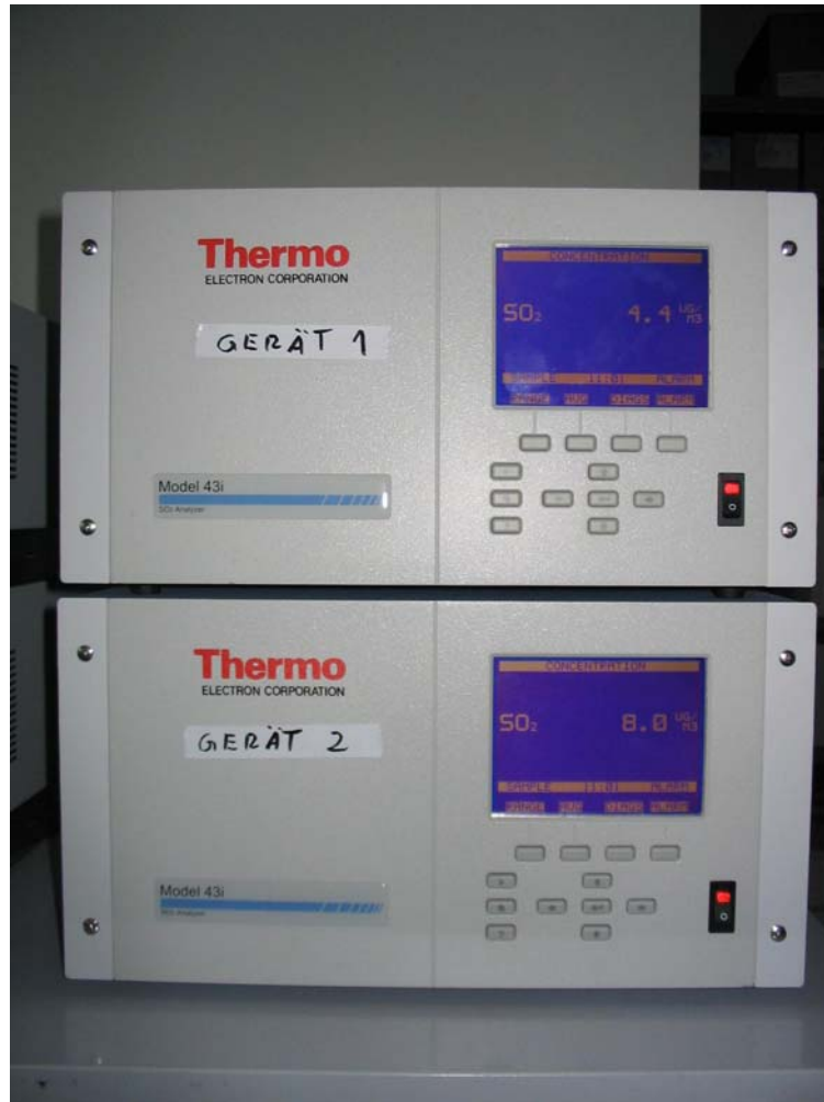
Abbildung 3: Frontaufnahme der im Messcontainer installierten Messeinrichtungen
